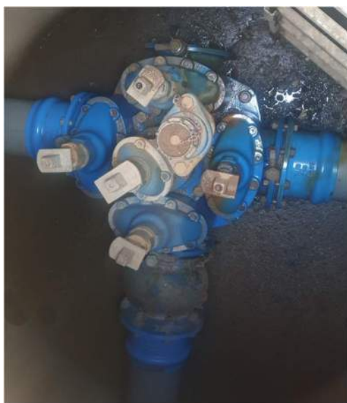
Figur 9 Eksisterende vannkum i Løykjelia. Tilknytning i retning sør utstyrt med tilbakeslagsventil
