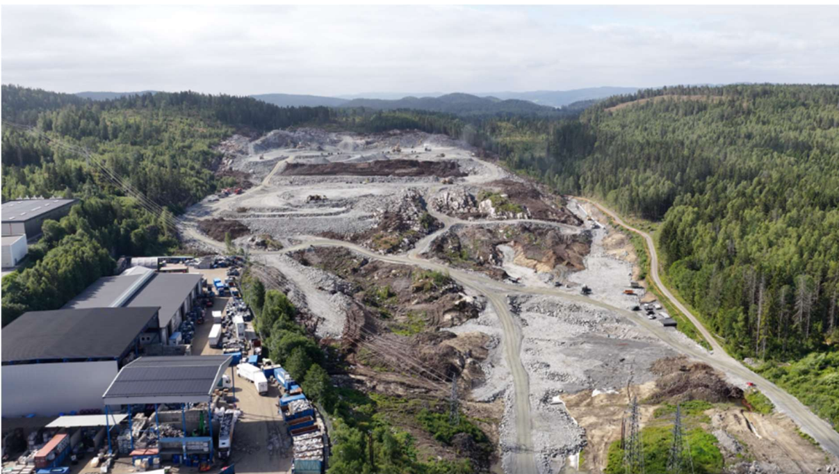
Figur 3-5: Foto av dagens situasjon som viser pågående tomteopparbeidelse (juni 2025).
