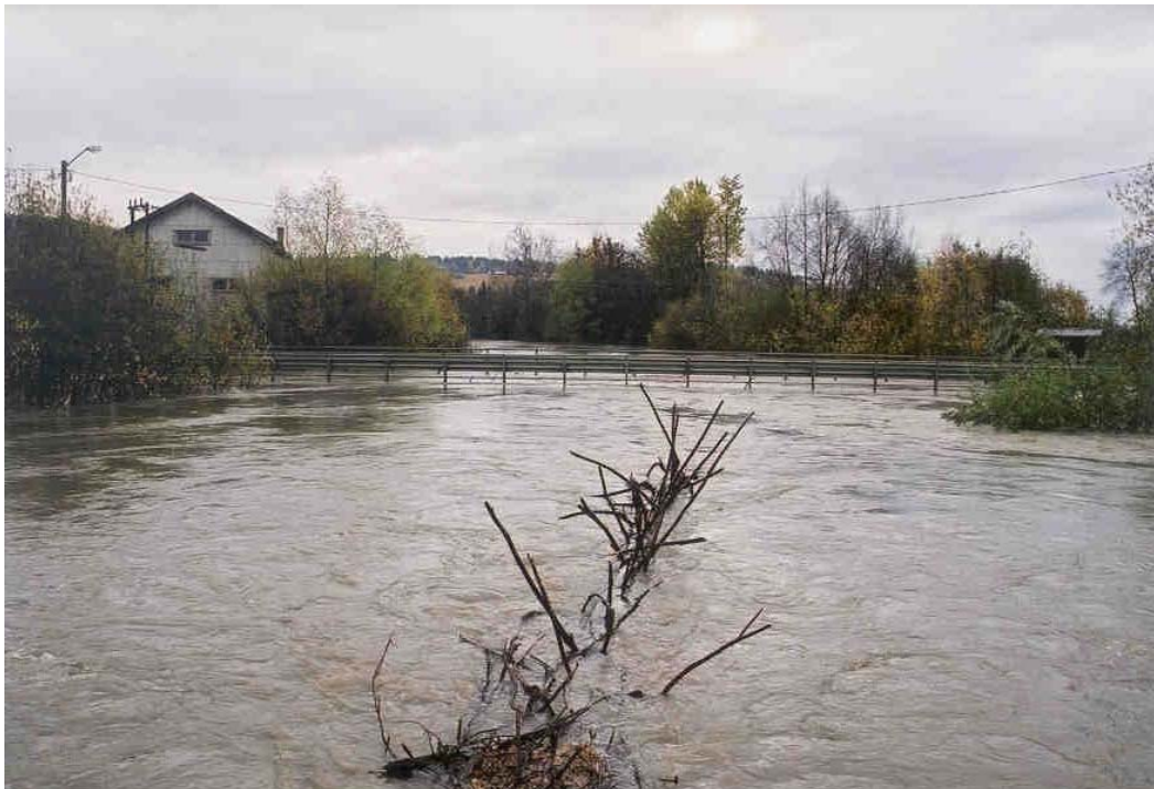
Figur 3-7 Veibru ved Leirsund under flommen i 2000. Foto: NVE
