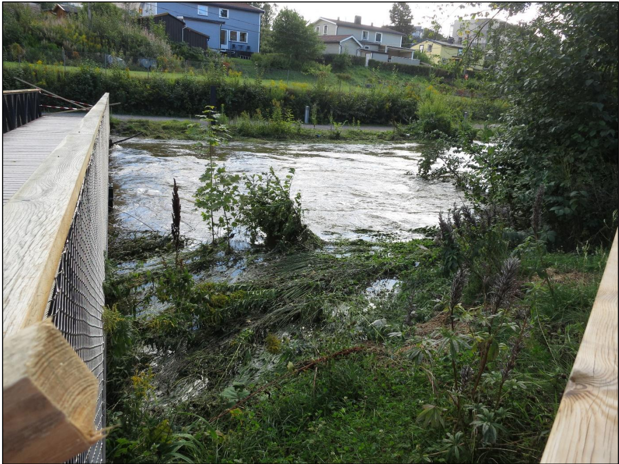
Figur 15. Gangbrua like ovenfor Flaenfossen i Sagelva etter kraftig nedbør 9. september 2015. Foto: Hilde Birkeland, Lillestrøm kommune
