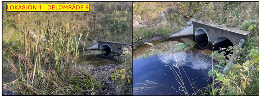
Figur 1.47: Bekk kommer ut av rør ved lokasjon 1, delområde 9, iht. figur 1.46. Relativt rolig bevegelse i vannet.
