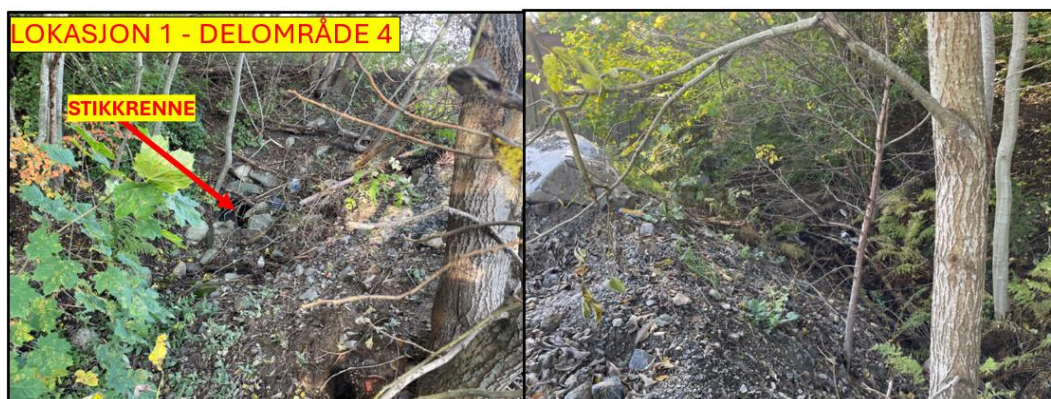
Figur 1.25: Stikkrenne sett fra sør (venstre), fyllmasser (høyre), Lokasjon 1, delområde 4, iht. figur 1.23.
