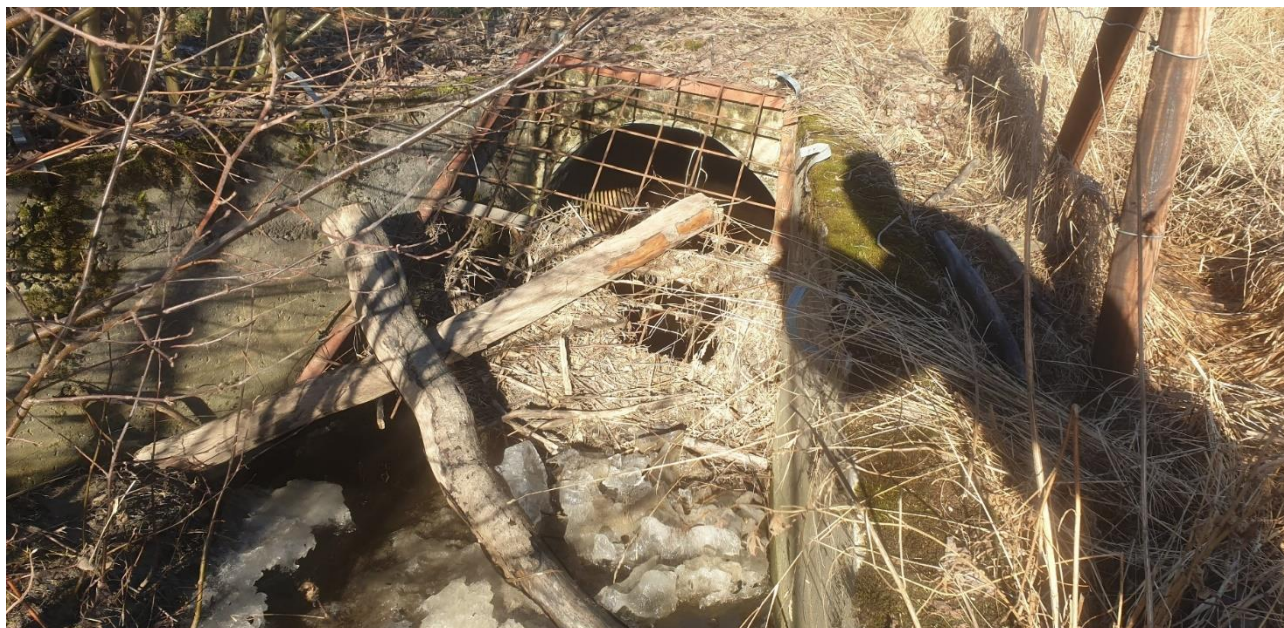
Figur 16: Bilde av kulvertinnløpet for Blakerbekken viser et eksempel på dårlig vedlikehold som medfører økt flomfare.
