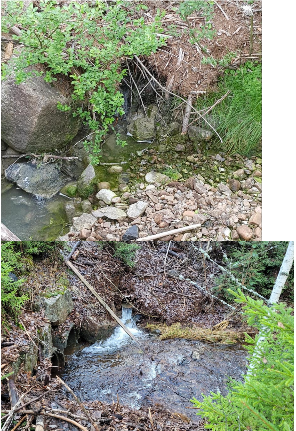
Figur 13: Foto av overvannsrør tatt i hhv. juni og november.
