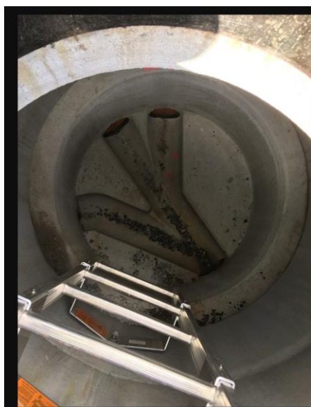
Figur 7 Det etableres en kum for å ta imot spillvannet fra pumpeledningen minst 3m fra dagens spillvannskum. Bildet viser dagens (eksisterende) spillvannskum som vil være tilkoblingspunkt for spillvann. Den er allerede klar for tilkobling.
