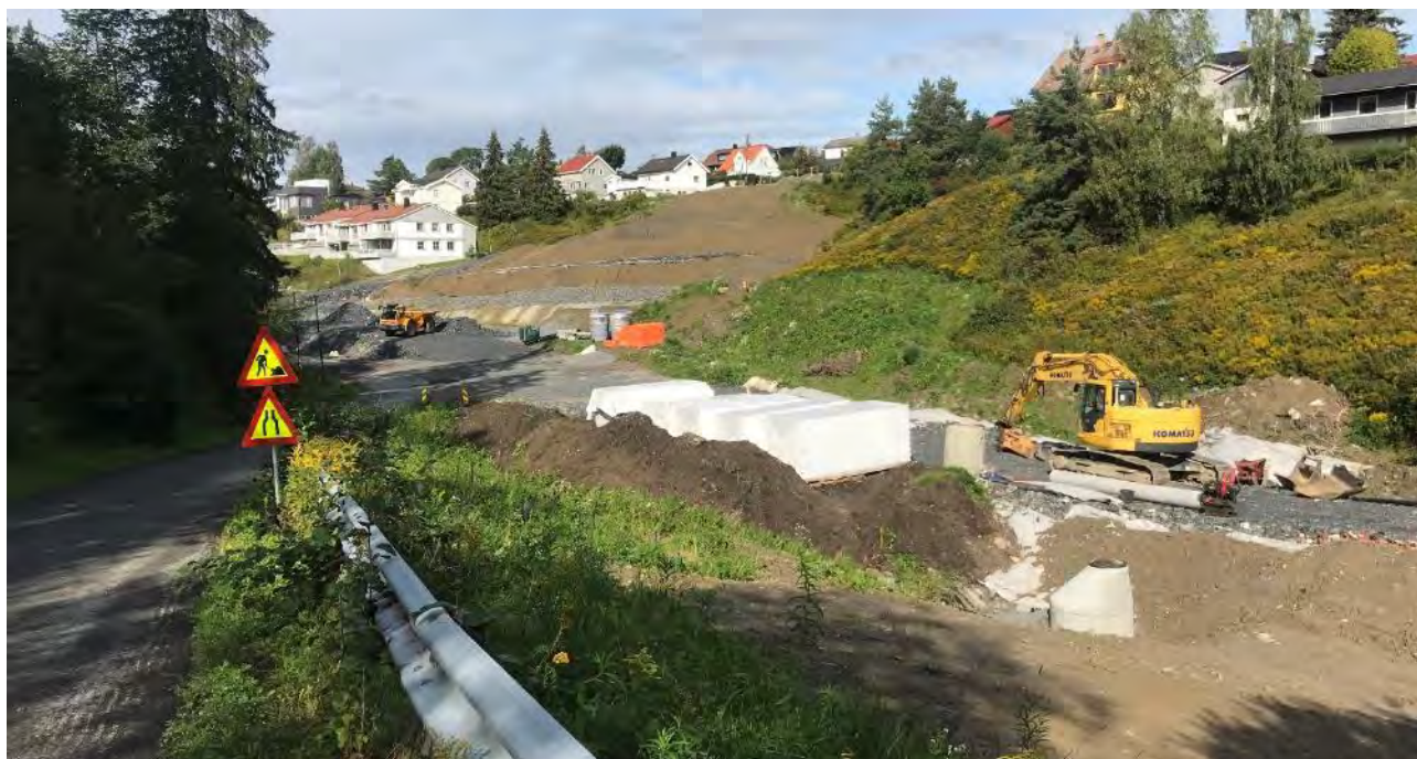
Figur 21 Det er nylig gjort store inngrep i den vestre delen av ravinen «Helladalen II».
